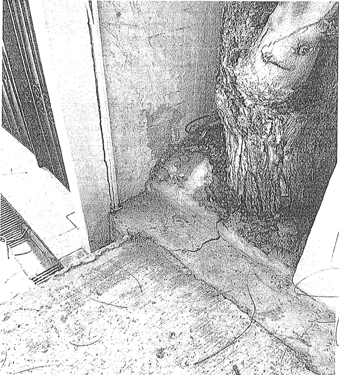
Fotografía de la base del árbol. Por el lugar de desarrollo, el crecimiento es reprimido y el daño al inmueble grave
