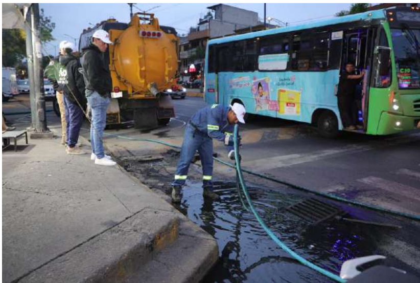
Desazolve de drenaje urbano. Camino Real a Toluca, Santa Fe, junio 12 de 2025. Foto: Álvaro Obregón.
