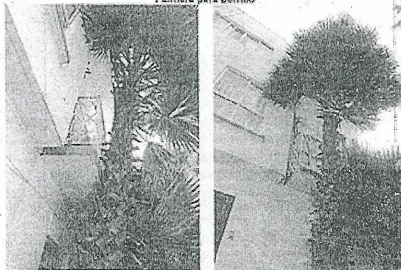
Afectación a cornisa y balcón
